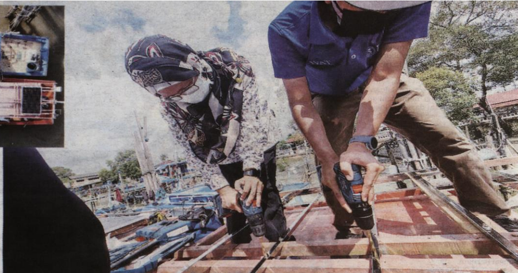
PASUKAN penyelidik daripada Sekolah Kejuruteraan Elektrik, UTM begitu komited semasa pemasangan panel solar pada bot nelayan di Mersing baru-baru ini.
